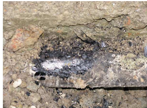
Рисунок 3 – Вигляд створеного наскрізного дефекту ізоляційного покриття
