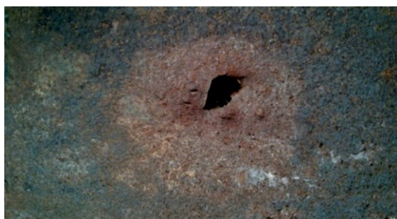
Рисунок 2. Сквозное повреждение коробчатого ПЖА
