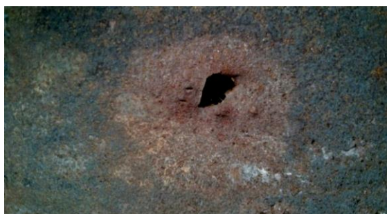
Рисунок 2. Сквозное повреждение коробчатого ПЖА
