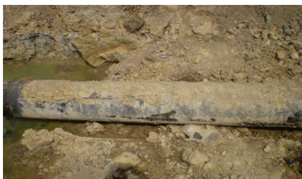
Рисунок 2 – Аварійна ділянка газопроводу
